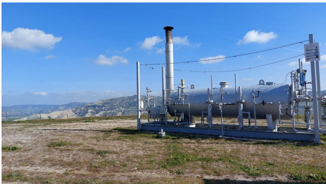
Figura 2 – Stralcio del piazzale pozzo AC1/5 presso la C.le Garaguso – Riscaldatore in primo piano
