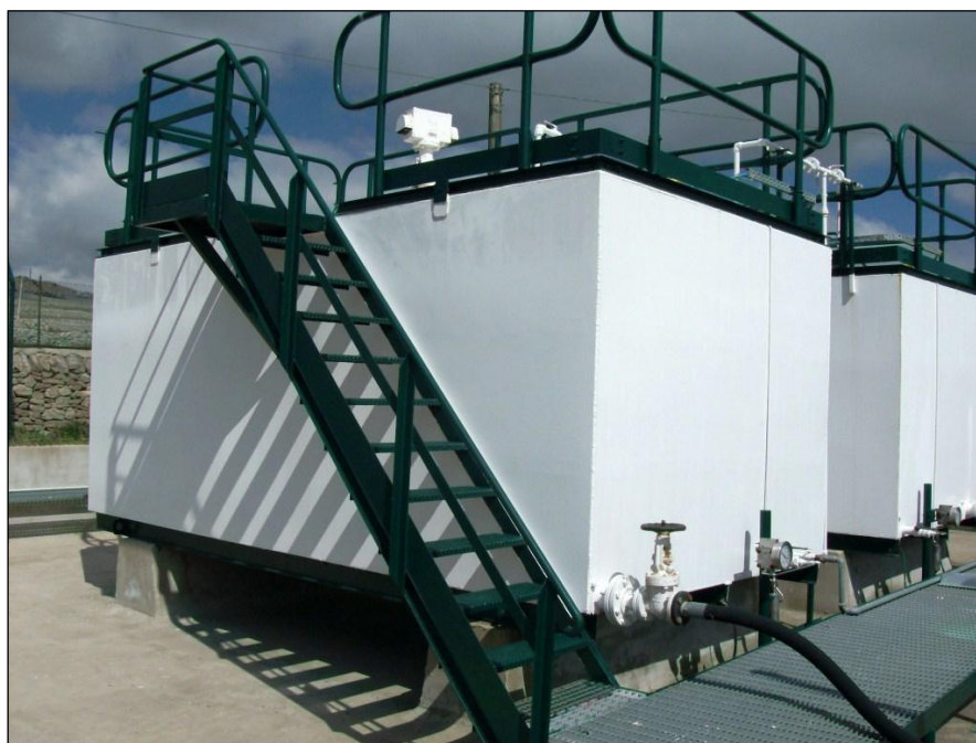
Figura 1 – Serbatoi acqua di strato centrale COMISO 2°
